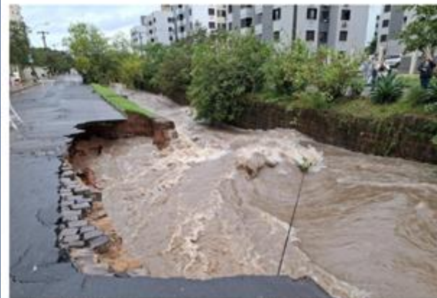
Avenida General Raphael Zippin desmoronou parcialmente com a queda do talude de contenção do Arroio das Pedras
